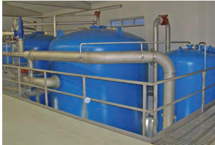
Die Filtration im Wasserwerk Erding
