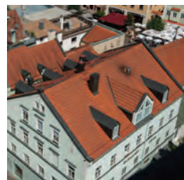
Abbildung 23d (unten) Schrannenplatz 2 - Gebäudeecke, Foto Naglik
